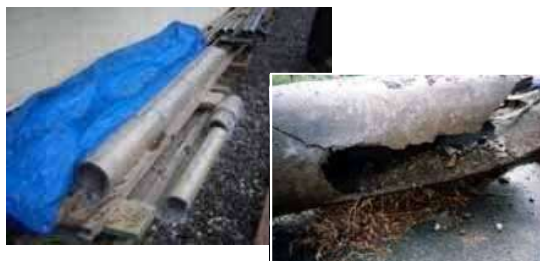
著しく老朽化し撤去された石綿セメント管
