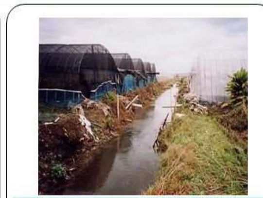
(事業実施前) 排水路の排水能力が低く、常に地下水位が高い状態で、収量・品質の低下が懸念される。
